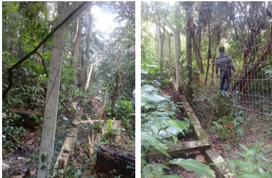
Figura 05 – Necessidade de reconstrução de alambrado
