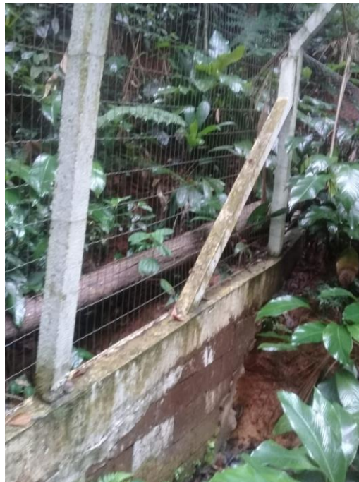
Figura 06 – Rompimento de parede de blocos
