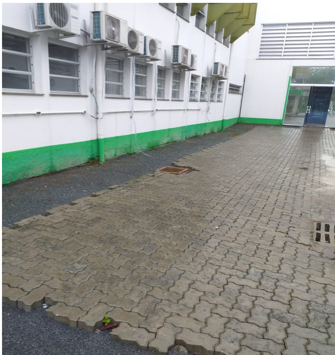
Foto 9: Estacionamento – Bloco B
