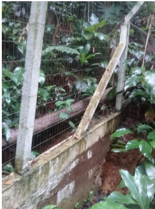
Figura 06 – Rompimento de parede de blocos
