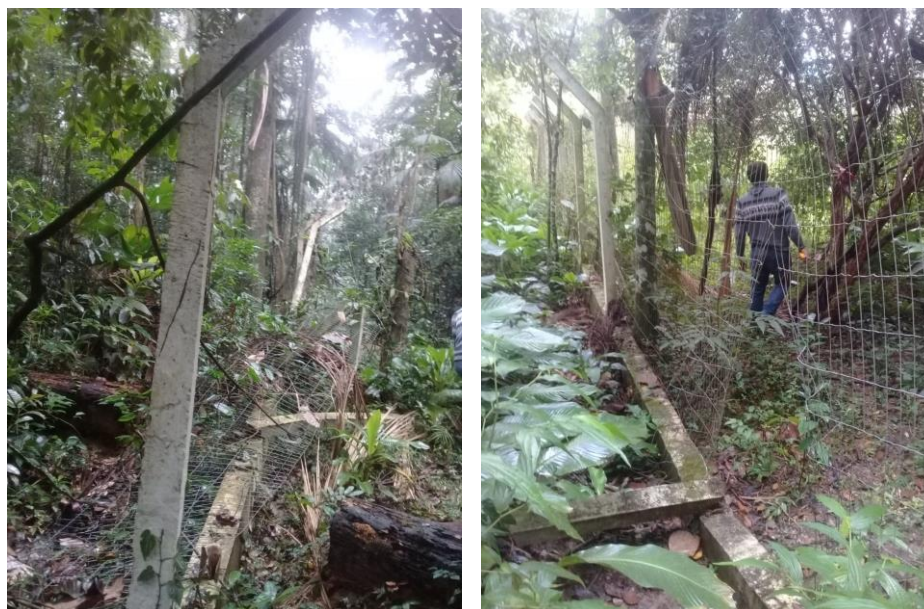
Figura 05 – Necessidade de reconstrução de alambrado
